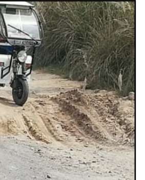
संपर्क मार्ग पहले से ही जर्जर अवस्था में था भारी वाहनों के आवागमन से मार्ग में डामर उखड़ गया है जगह जगह पर बड़े बड़े गड्डे हो गए है। पूरे दिन में सैकड़ों की संख्या में भारी वाहन निकलने की वजह से रोड की धूम्रियां उड़ रही है व जगह जगह पर जाम की स्थिति
